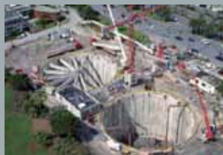
Bassins de rétention à Ferber
